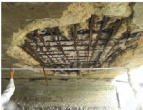
内部の鉄筋が露出した橋梁
