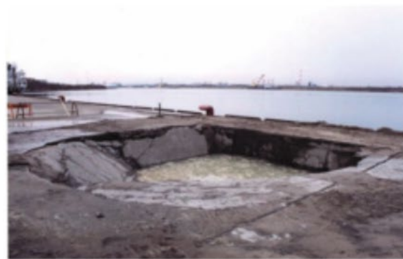
陥没した港湾施設のエプロン部分
